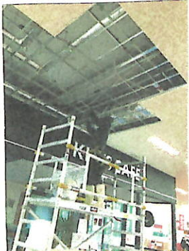
アピタ店1階の天井も落下
